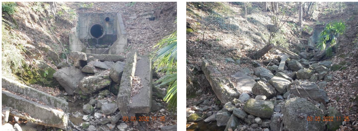
Figura 13 - Accumulo di materiale e detriti vari all'uscita del riale Veregela incanalato
