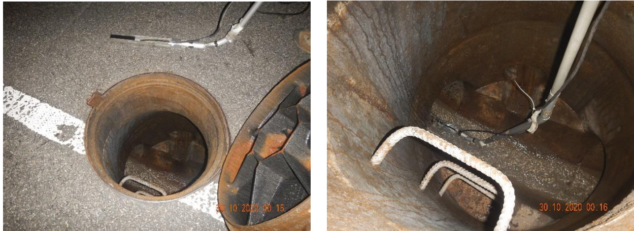
Figura 29 - Strumentazione di misura e presenza acque chiare pz. 5363001780
